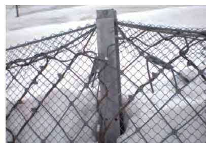
ひし形金網への変形状況 (φ3.2×50×50の変更ににより補強効果あり)
