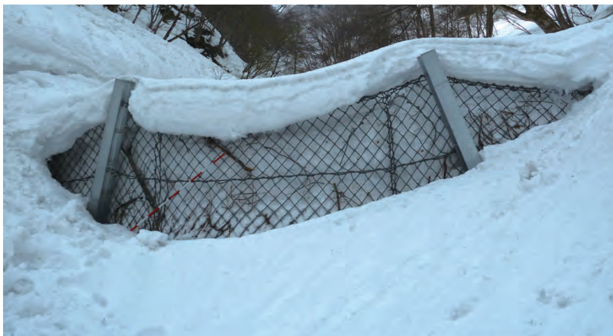
雪崩の流下を受け止めた状況
