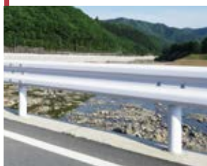
ガードレール
