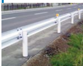
ガードレール
