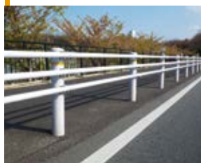
ガードパイプ
