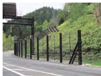
■落石防止柵 落石エネルギー ～約50kJ※ P45 →
