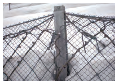
ひし形金網の変形状況 (φ3.2×50×50の変更により補強効果あり)
