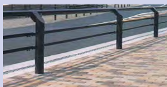
ガードパイプ
